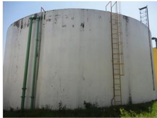
Figura 42. Reservatório Semi-Enterrado: EAT Jardim Cidade (Siemens).
