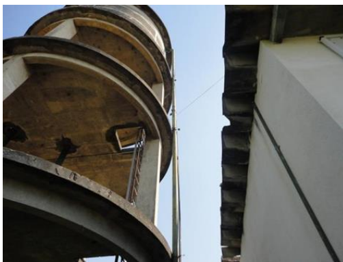
Figura 51. Reservatório Elevado EAT Jurumirim.
