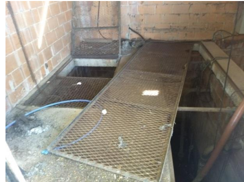
Figura 125. Estação Elevatória de Esgoto – Casa Verde - Vista 2.
