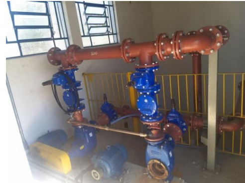
Figura 119. Vista do conjunto motor-bomba.
