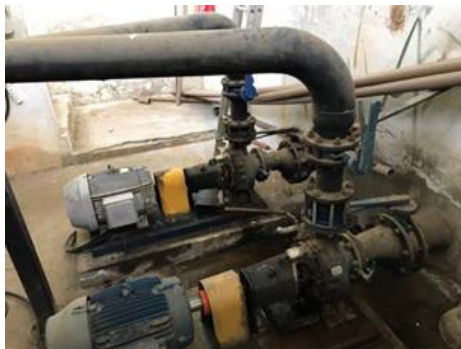
Figura 35. Conjunto –motor bomba para o abastecimento do Reservatório Elevado do EAT Nova Era.
