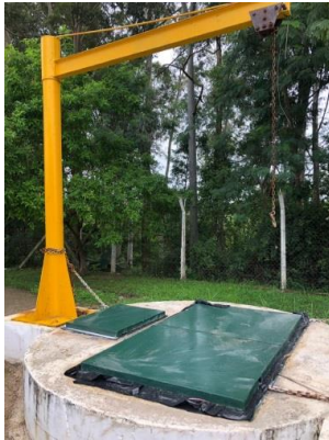
Figura 153. Estação Elevatória de Esgoto – Guaraú II - Vista 3.
