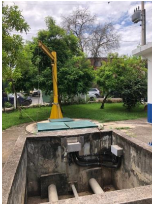
Figura 149. Estação Elevatória de Esgoto – Guarau I - Vista 3.
