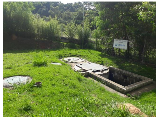
Figura 172. Estação Elevatória de Esgoto – Rondon - Vista 2.
