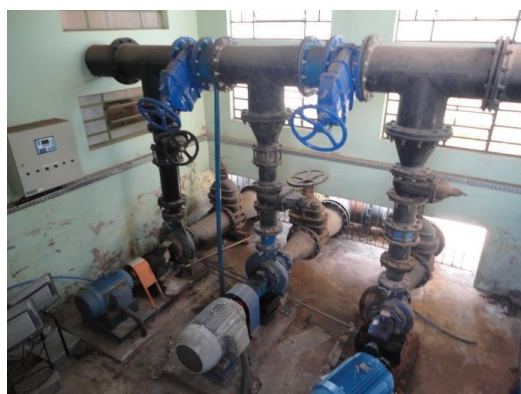
Figura 60. Recalque dos três conjuntos motor - bomba do EAT João Jabour
