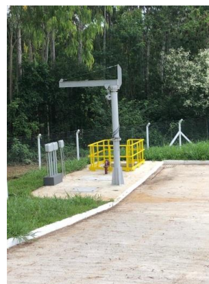
Figura 180. Estação Elevatória de Esgoto – M. Paulina - Vista 2.
