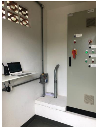
Figura 181. Estação Elevatória de Esgoto – M. Paulina - Vista 3.
