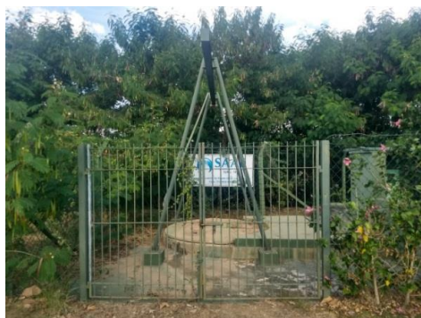
Figura 126. Estação Elevatória de Esgoto – D'Icarai - Vista 1.
