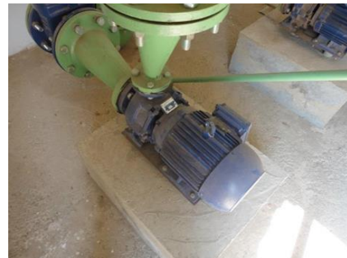
Figura 75. Conjunto moto - bomba do EAT Portal dos Bandeirantes.
