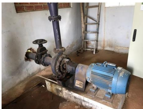
Figura 30. Conjunto motor bomba para o abastecimento do Reservatório Elevado.
