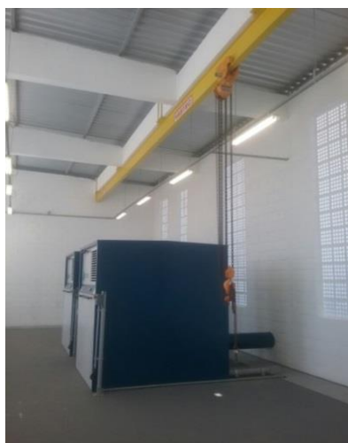
Figura 113. Vista do Sistema de Aeração por sopradores tipo "roots".
