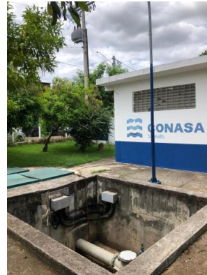
Figura 150. Estação Elevatória de Esgoto – Guarau I - Vista 4.
