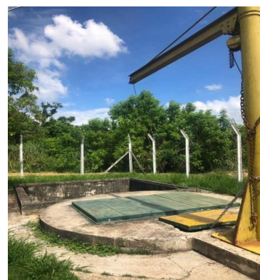
Figura 140. Estação Elevatória de Esgoto – Buru I - Vista 2.
