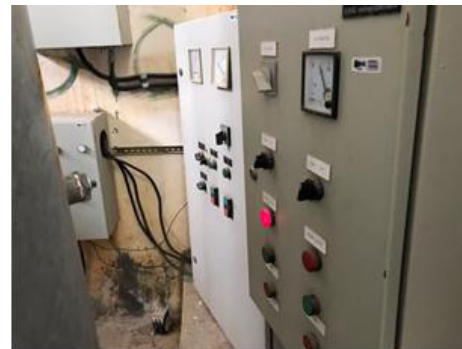
Figura 36. Vista Geral dos painéis de energia do conjunto motor bomba do EAT Nova Era.
