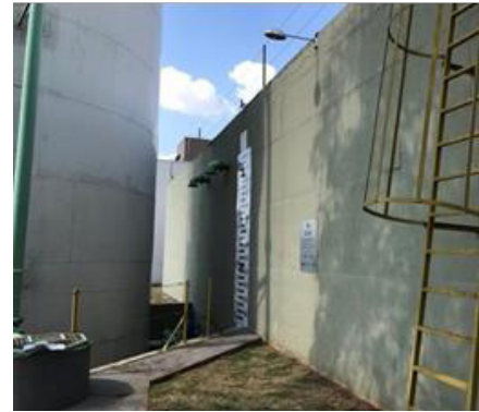
Figura 70. Reservatório Apoiado EAT D'Icaraí.
