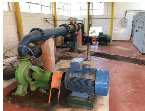
Figura 16. Vista Geral do barrilete de recalque da captação.
