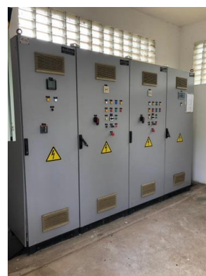
Figura 148. Estação Elevatória de Esgoto – Guaraú I - Vista 2.
