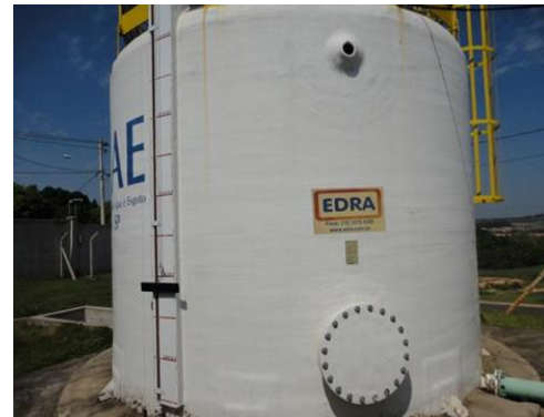
Figura 73. Reservatório Apoiado EAT Portal dos Bandeirantes.
