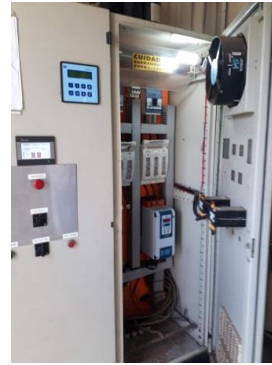
Figura 158. Estação Elevatória de Esgoto – 01 - Vista 4.
