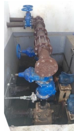
Figura 138. Estação Elevatória de Esgoto – Moutonné - Vista 2.
