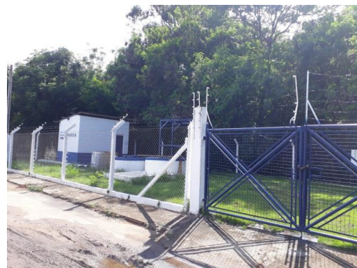
Figura 176. Estação Elevatória de Esgoto – Nações - Vista 2.
