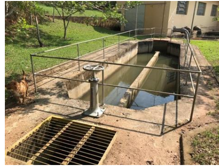
Figura 14. Vista Geral da caixa de areia na captação do Ribeirão Pirai.
