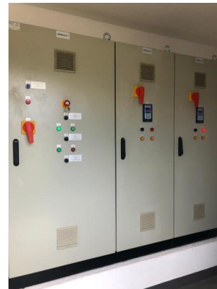
Figura 182. Estação Elevatória de Esgoto – M. Paulina - Vista 4.
