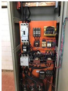
Figura 17. Vista Geral do painel elétrico das bombas.
