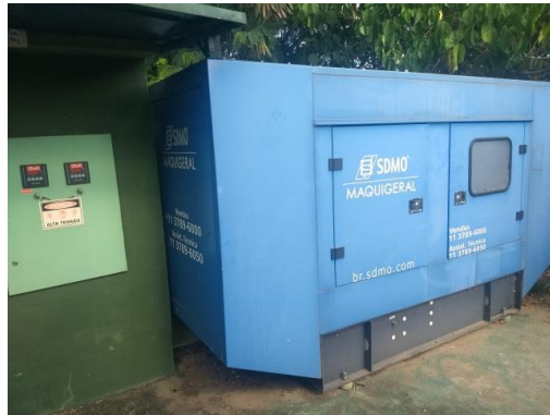
Figura 128. Estação Elevatória de Esgoto – D'Icarai - Vista 3.
