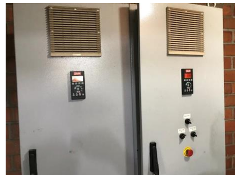
Figura 90. Vista Geral dos Painéis de Energização do Booster Telesi.
