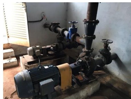
Figura 31. Conjunto motor bomba para o abastecimento da rede de distribuição e Reservatório Apoiado Icaraí.
