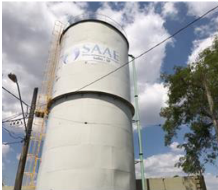
Figura 69. Reservatório Elevado EAT D'Icaraí.
