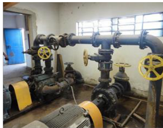
Figura 92. Vista Geral dos conjuntos motor-bomba do Booster Estação.
