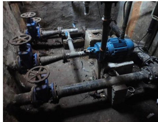
Figura 56. Conjunto motor - bomba do EAT Haras Paineiras.
