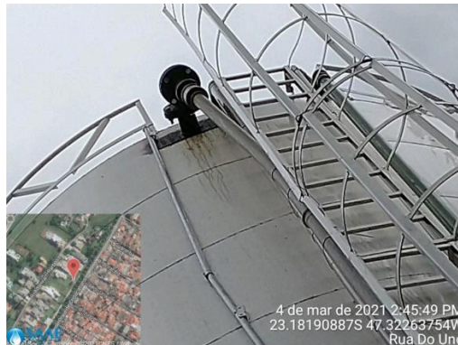
Figura 88. Sistema de Reservação EAT Monte Serrat
