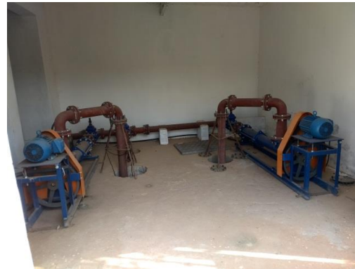
Figura 136. Estação Elevatória de Esgoto – Portal dos Bandeirantes - Vista 2.
