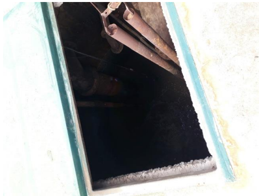
Figura 177. Estação Elevatória de Esgoto – Nações - Vista 3.
