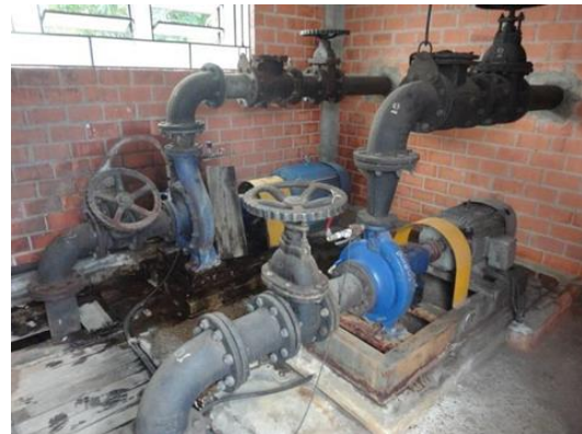
Figura 96. Vista Geral dos conjuntos motor-bomba do Booster Floriano.
