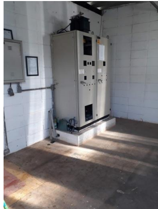
Figura 165. Estação Elevatória de Esgoto – 03 - Vista 3.
