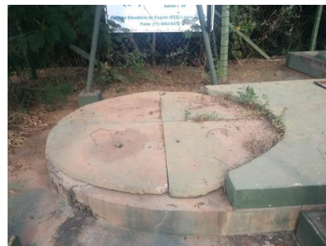
Figura 127. Estação Elevatória de Esgoto – D'Icarai - Vista 2.
