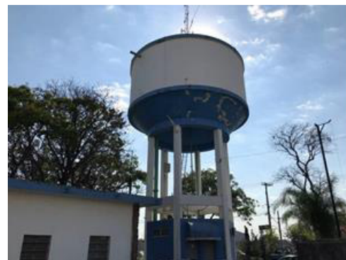
Figura 46. Reservatório Elevado – EAT SAAE.
