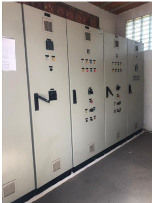
Figura 141. Estação Elevatória de Esgoto – Buru I - Vista 3.
