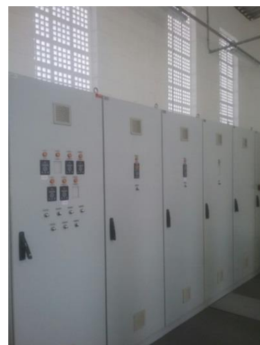
Figura 114. Vista dos painéis elétricos dos Sopradores.
