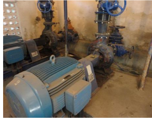
Figura 94. Vista Geral dos conjuntos motor-bomba do Booster dos Trabalhadores.
