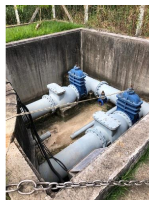
Figura 144. Estação Elevatória de Esgoto – Buru II - Vista 2.
