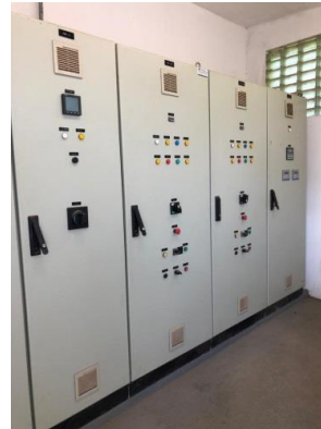
Figura 146. Estação Elevatória de Esgoto – Buru II - Vista 4.
