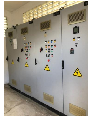
Figura 154. Estação Elevatória de Esgoto – Guaraú II - Vista 4.
