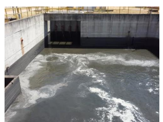
Figura 108. Vista do Tanque de Equalização de efluente.
