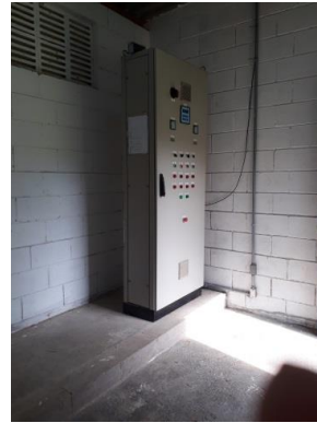
Figura 174. Estação Elevatória de Esgoto – Rondon - Vista 4.
