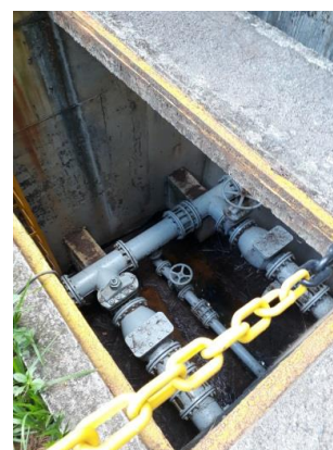
Figura 156. Estação Elevatória de Esgoto – 01 - Vista 2.
