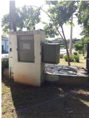
Figura 161. Estação Elevatória de Esgoto – 02 - Vista 3.
