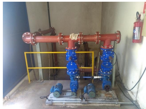
Figura 117. Vista do conjunto motor-bomba.
