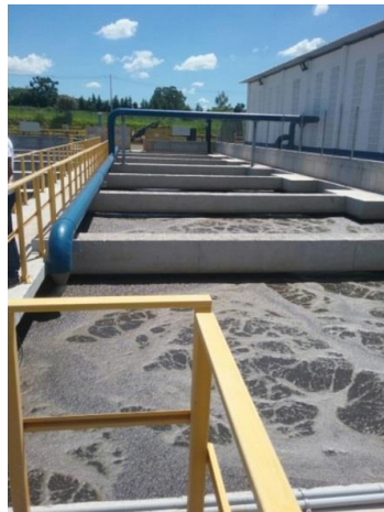
Figura 109. Vista do Tanque de Aeração.
