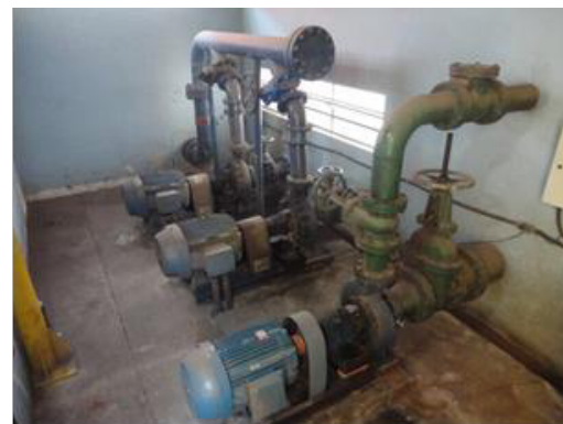
Figura 44. Conjunto de moto - bombas do EAT Jardim Cidade (Siemens).
