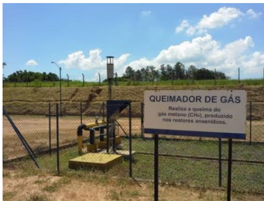
Figura 111. Vista do Sistema de Queima de gás Metano.
