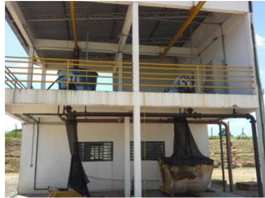
Figura 104. Vista do sistema de Desidratação de lodo por centrifugação.
