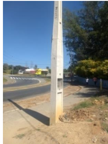
Figura 123. Vista do poste onde localiza-se o disjuntor de acionamento da bomba.
