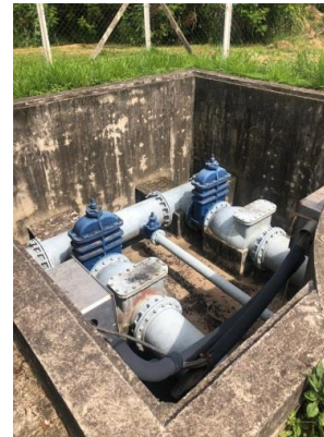
Figura 142. Estação Elevatória de Esgoto – Buru I - Vista 4.
