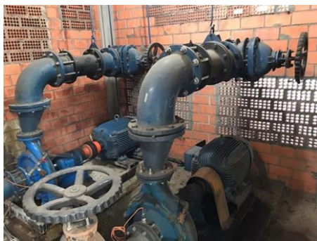
Figura 89. Vista Geral dos conjuntos motor-bomba do Booster Telesi.
