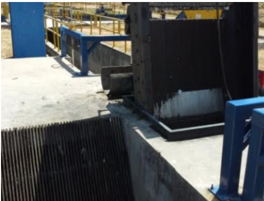
Figura 105. Vista do Gradeamento Grosseiro do efluente bruto.
