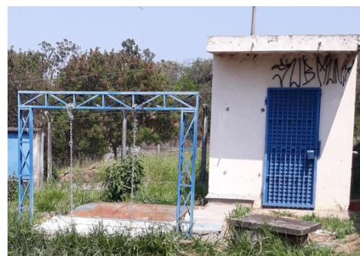
Figura 121. Estação Elevatória – Monte Carlo - Vista 2.
