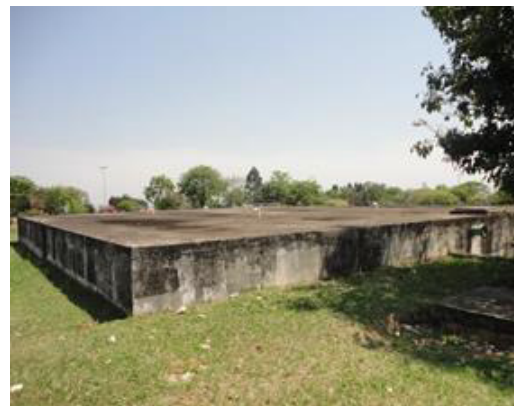
Figura 38. Reservatório Semi-Enterrado: RSE 01 EAT Santa Cruz.
