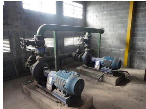
Figura 65. Recalque dos dois conjuntos motor - bomba do EAT Jardim Panorama.
