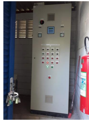
Figura 178. Estação Elevatória de Esgoto – Nações - Vista 4.
