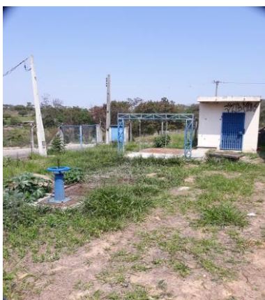
Figura 120. Estação Elevatória – Monte Carlo - Vista 1.
