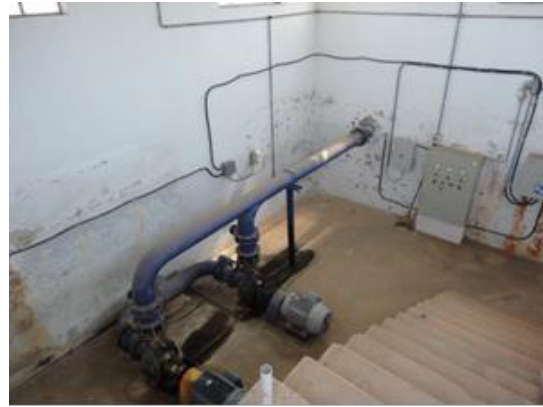
Figura 40. Conjunto –motor bomba para o abastecimento do Reservatório Elevado – REL 03.
