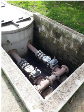
Figura 173. Estação Elevatória de Esgoto – Rondon - Vista 3.
