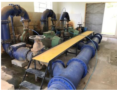
Figura 15. Vista Geral do barrilete de recalque da captação.
