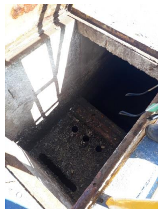
Figura 164. Estação Elevatória de Esgoto – 03 - Vista 2.
