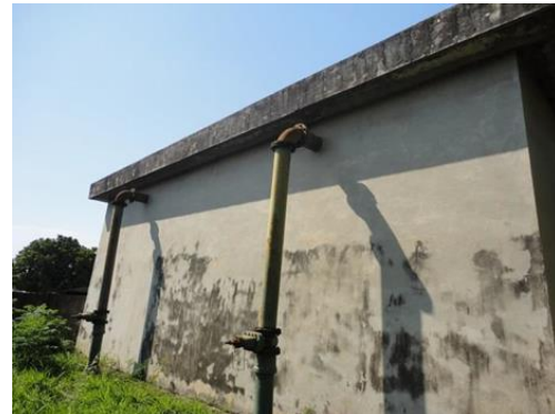
Figura 50. Reservatório Semi-Enterrado EAT Jurumirim.
