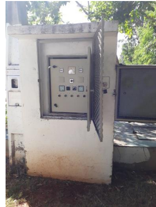
Figura 162. Estação Elevatória de Esgoto – 02 - Vista 4.
