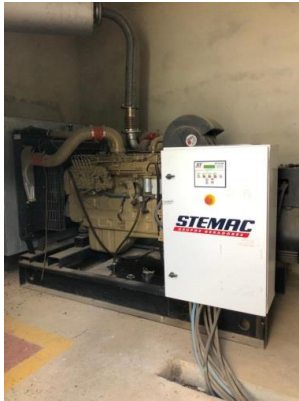
Figura 145. Estação Elevatória de Esgoto – Buru II - Vista 3.
