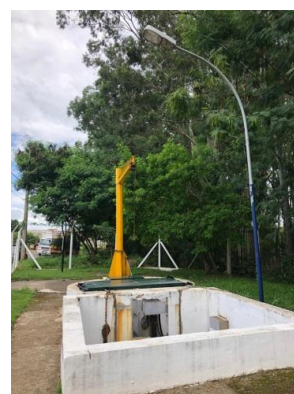
Figura 152. Estação Elevatória de Esgoto – Guarau II - Vista 2.
