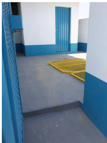
Figura 129. Estação Elevatória de Esgoto – Bandeirantes - Vista 1.
