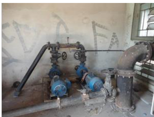
Figura 59. Recalque dos dois conjuntos motor - bomba do EAT João Jabour.
