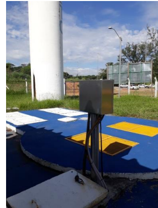
Figura 166. Estação Elevatória de Esgoto – 03 - Vista 4.
