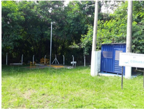
Figura 157. Estação Elevatória de Esgoto – 01 - Vista 3.
