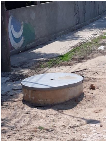
Figura 122. Elevatória de Esgoto – Ribeirão Preto.
