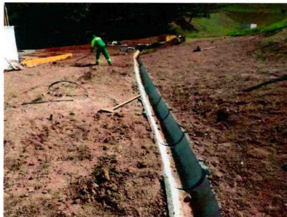
Figura 60- Canaletas De Drenagem
